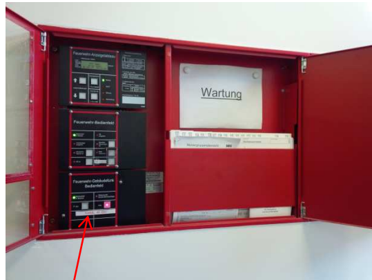
Gebädefunk-Bedienfeld unter Feuerwehrbedienfeld
