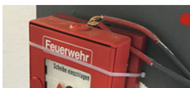
BMA + SAA: Brandmeldeanlagen in der Praxis
