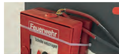
BMA + SAA: Brandmeldeanlagen in der Praxis
