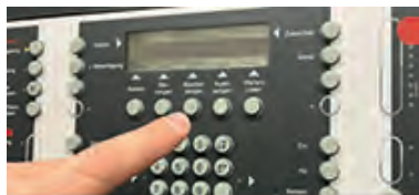
BMA: Betrieb und Wartung von Brandmeldeanlagen
